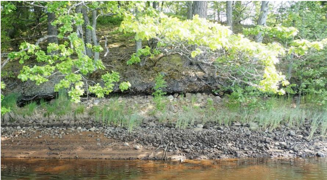
Figur 3-14. Underminerad strandlinje höger sida, uppströms Bassalt regleringsdamm (Sweco, 2023).
